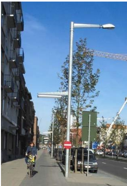
Foto 4.28 Lichtmast met twee lichtpunten - Leuven
