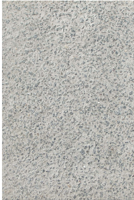
Chemisch uitgewassen doorgaand gewapend beton
