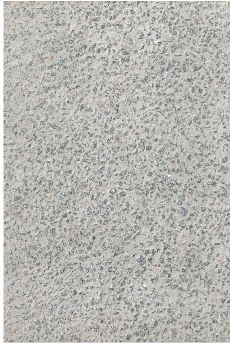
Chemisch uitgewassen doorgaand gewapend beton
