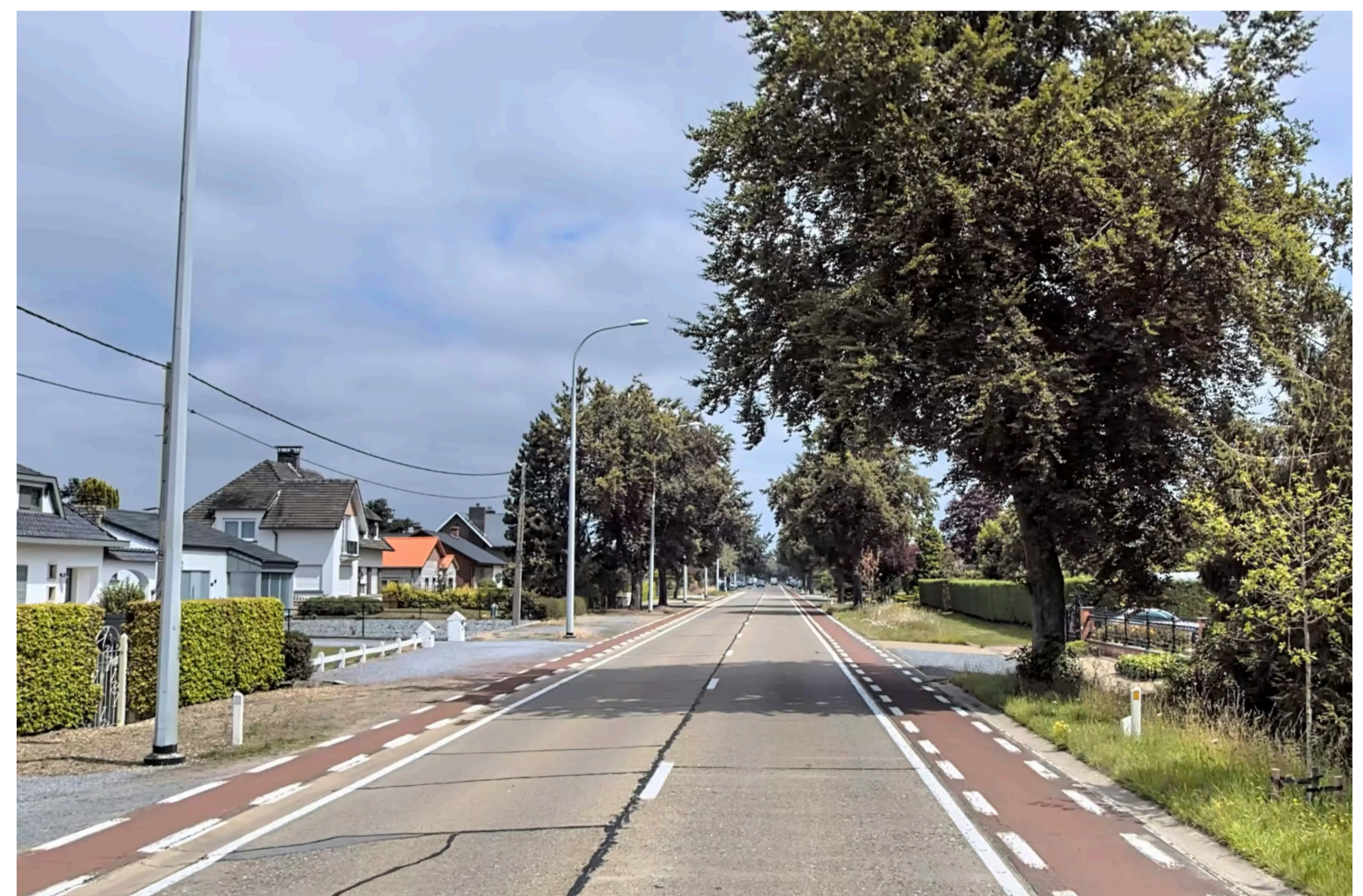
Beton wegdek op N29 in slechte staat
