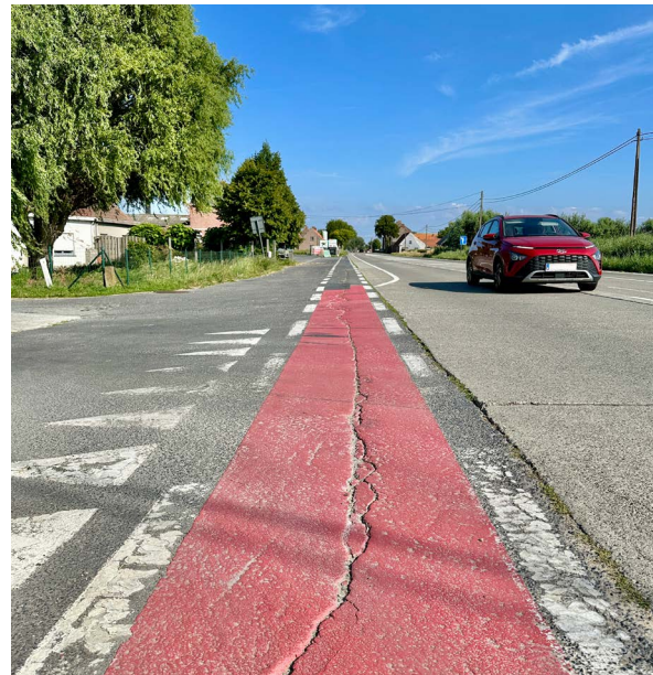
Op veel plaatsen in het onderzoeksgebied is de fietsinfrastructuur op heden zeer onveilig.
