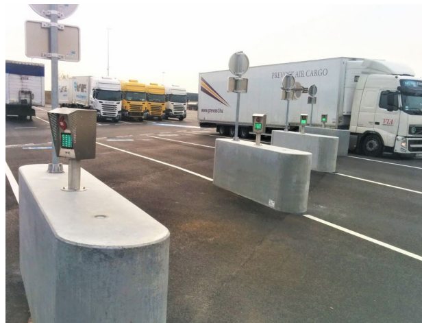
Stroomconnectiepunten voor vrachtwagens (2017, Oostenrijk)
