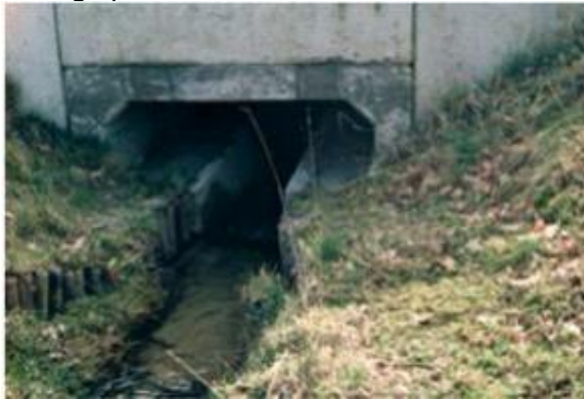
Voorbeeld van een ecoduker met aan beide zijden een loopstrook waarin grond is aangebracht
