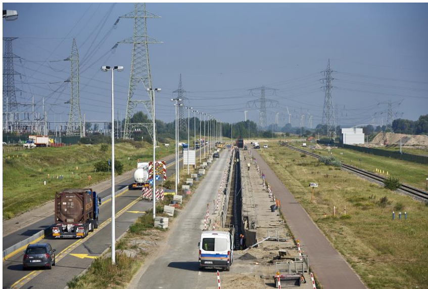
Foto: kabels in open sleuf boven het sluisencomplex
